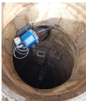
Control de nivel de fosas de aguas residuales
