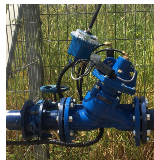
Control de Caudal y Presión
